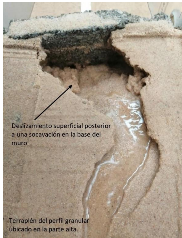
Figura 6. Presentación de la socavación del muro de contención y deslizamiento superficial en la parte alta del perfil granular, generados por el gradiente más desfavorable.
